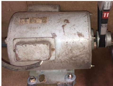
Figura 19. Motor de la sección de mezclador.
