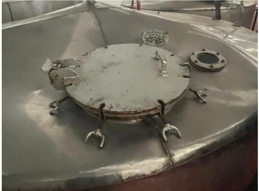
Imagen 26 Acceso a tanques para personal de mantenimiento. Fuente: Autor.
