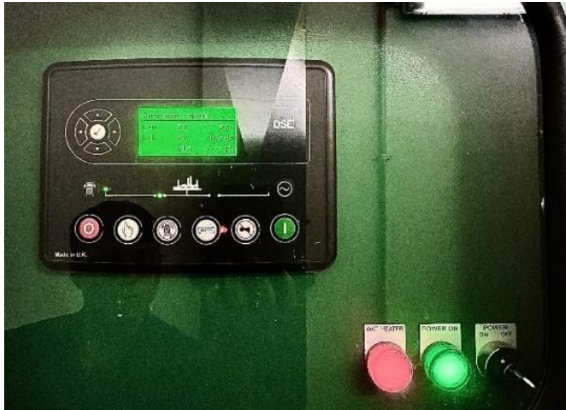
Imagen 17 Panel de control planta auxiliar. Fuente: Autor.
