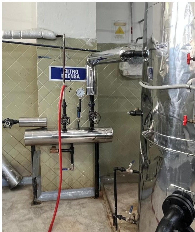
Imagen 63 Filtro y trampa de vapor. Fuente: Autor.
