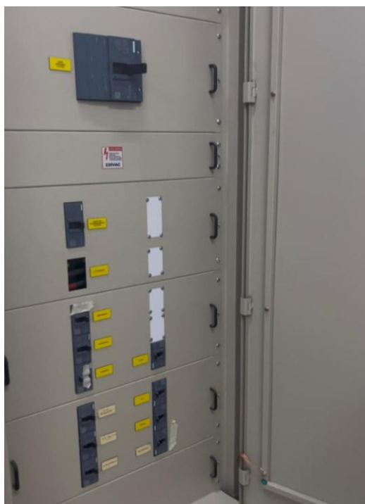
Imagen 13 Paneles de distribución. Fuente: Autor.
