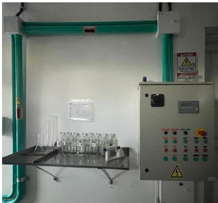
Imagen 29 Tablero de control de preparación. Fuente: Autor.
