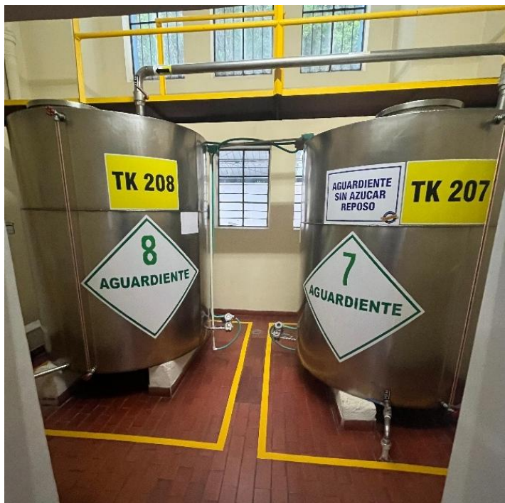
Imagen 33 Tanques auxiliares de reposo. Fuente: Autor.
