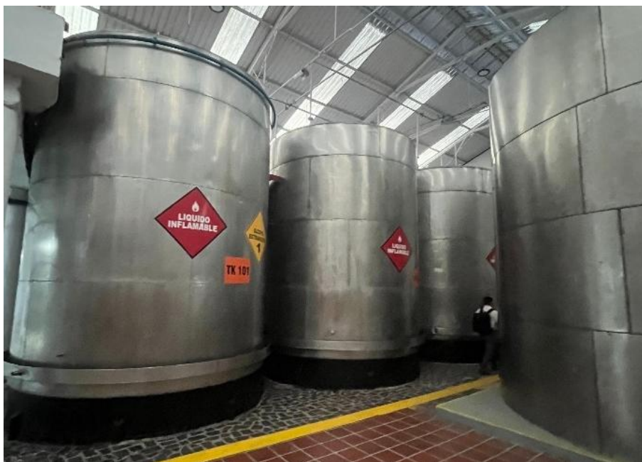
Imagen 23 Tanques de almacenamiento de alcohol (2/3). Fuente: Autor.
