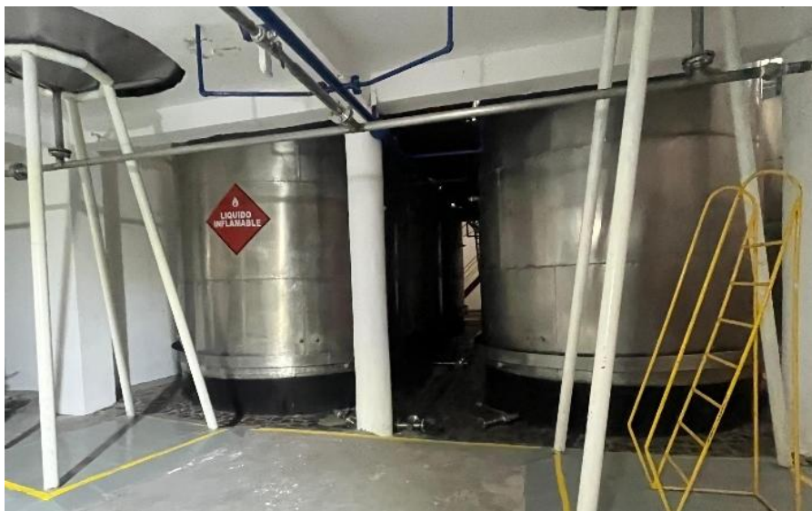
Imagen 22 Tanques de almacenamiento de alcohol (1/3). Fuente: Autor.
