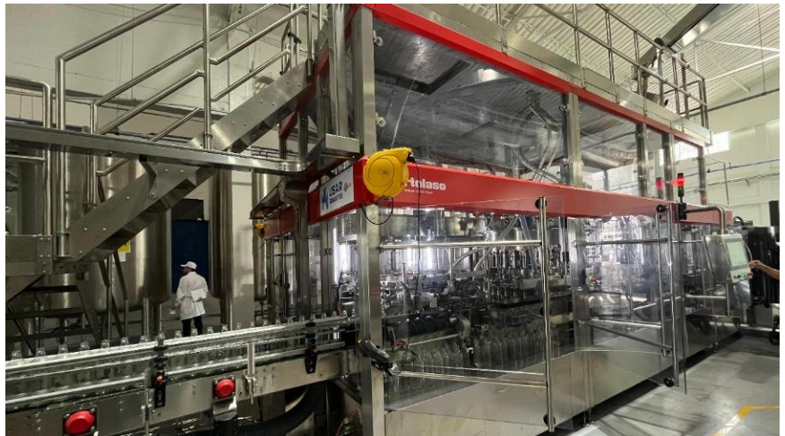
Imagen 49 Triblock de lavado, llenado y sellado L-2. Fuente: Autor.
