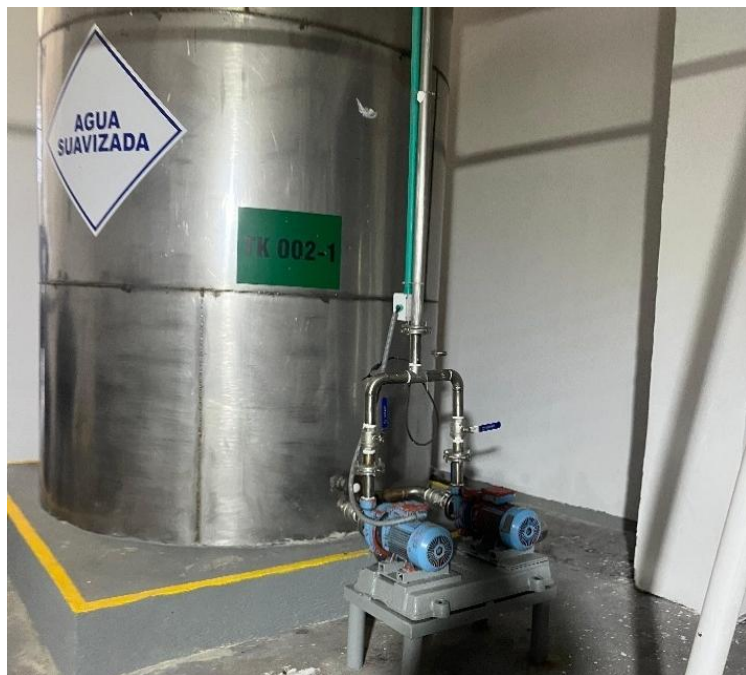
Imagen 21 Agua suavizada. Fuente: Autor.
