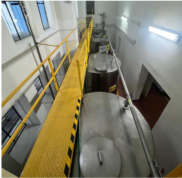
Imagen 28 Tanques de reposo. Fuente: Autor.
