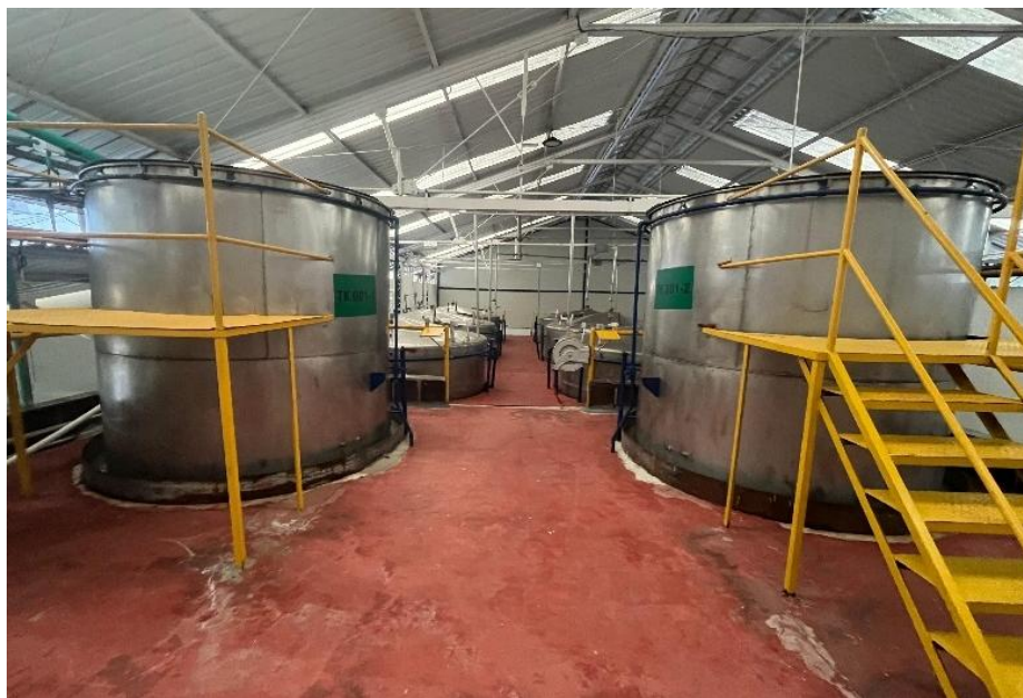
Imagen 25 Tanques madre para almacenamiento de agua. Fuente: Autor.
