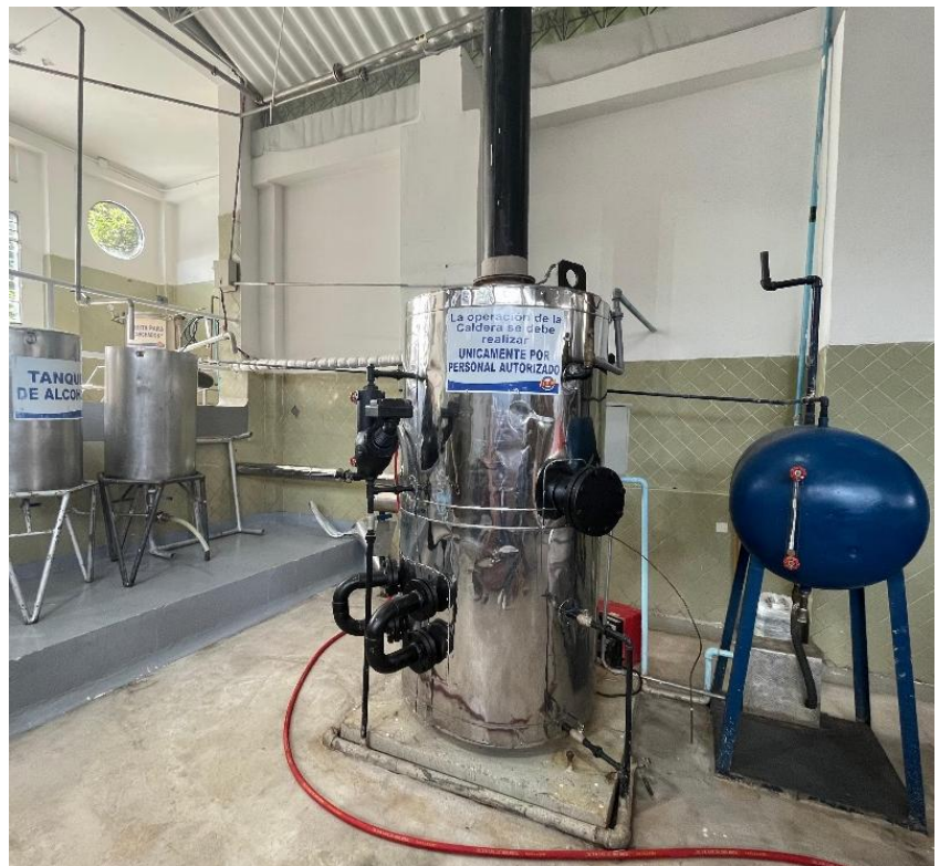
Imagen 62 Calderín pirotubular. Fuente: Autor.
