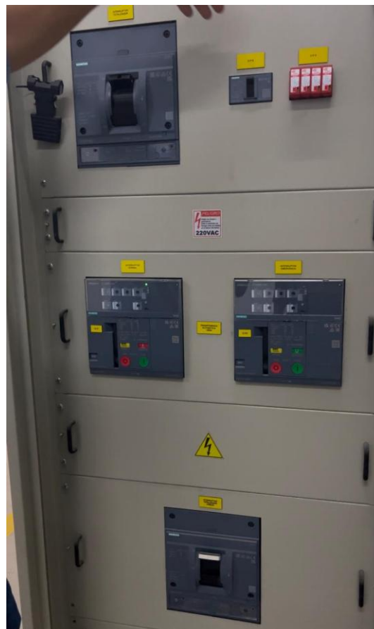
Imagen 15 Panel de transferencia (interior) Red externa-Planta auxiliar. Fuente: Autor.
