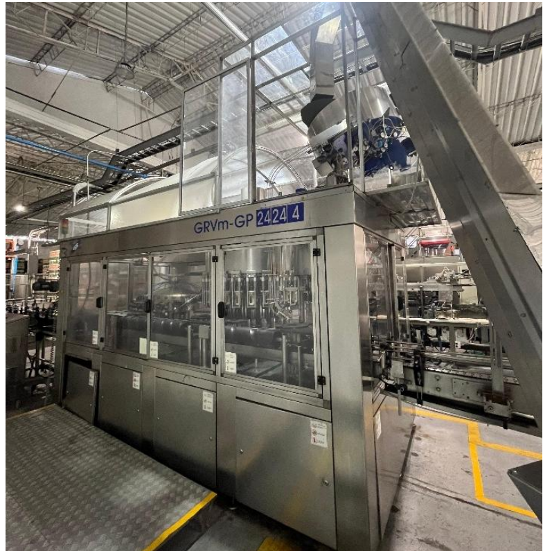
Imagen 40 Triblock de lavado, llenado y sellado L1. Fuente: Autor.
