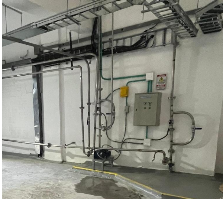
Imagen 20 Tablero de control de circuito de aguas. Fuente: Autor.
