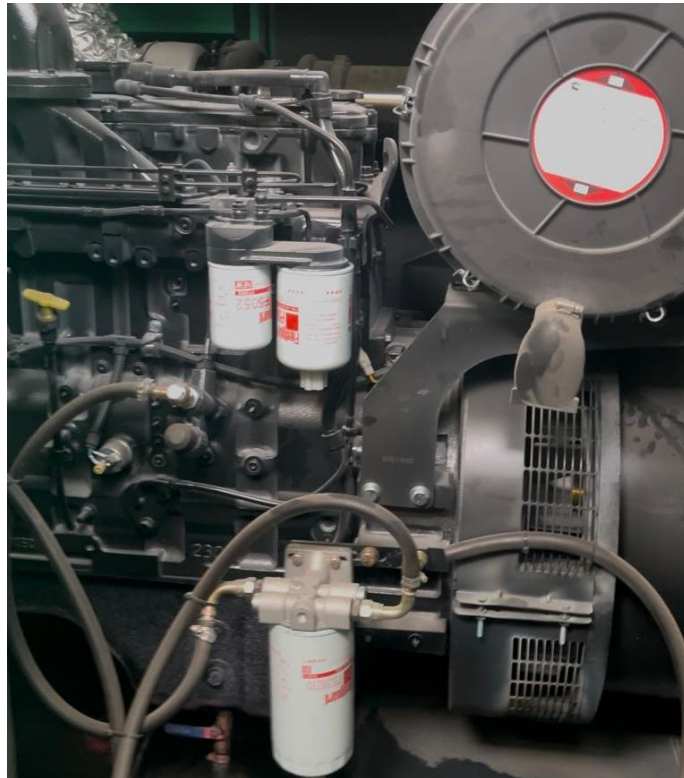
Imagen 18 Planta auxiliar (interior 1/2). Fuente: Autor.
