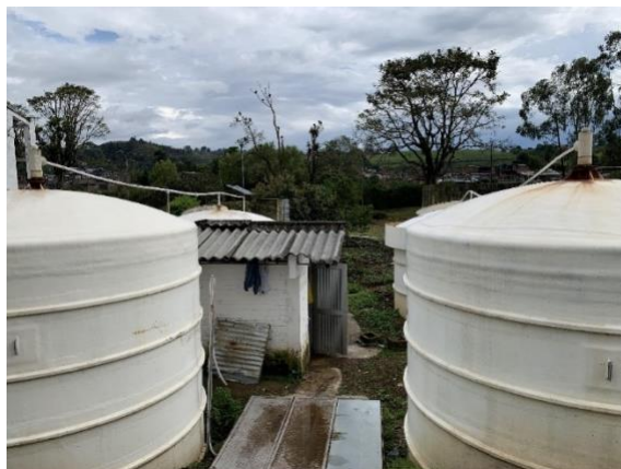
Figura 16. Planta de tratamiento (Fuente el autor)
