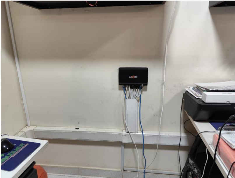
Ilustración 28 Punto de distribución de red con cableado expuesto
